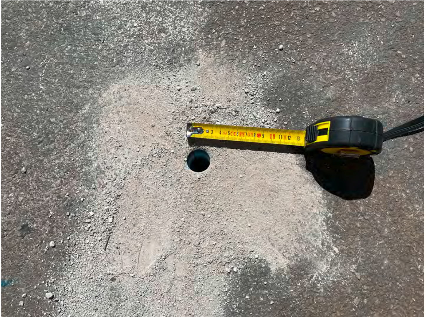
Particolare di un tubo interrato a filo della pavimentazione industriale in asfalto
